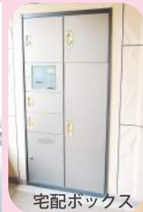
宅配ボックス
